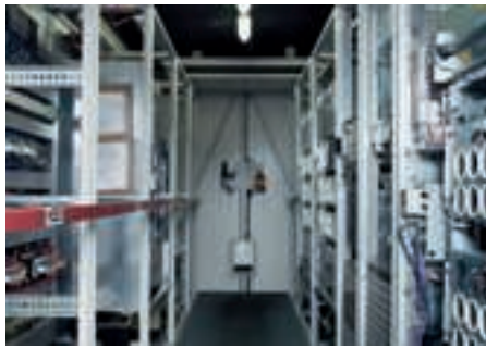
↑ Los armarios de conexiones eléctricas abiertos se imponen cada vez más
