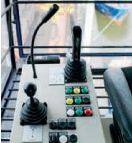
↑ Disposición clara y ergonómica de los instrumentos de control en la silla del operador de la grúa
